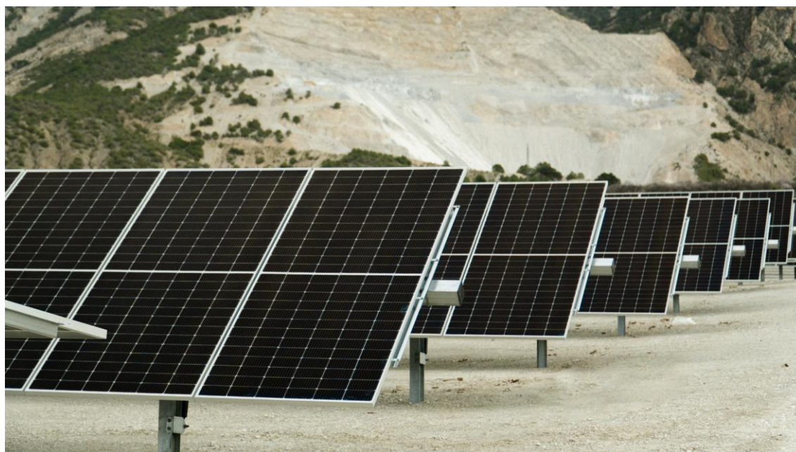
Foto: Planta solar fotovoltaica construida por Cuerva en Dúrcal (Granada)
