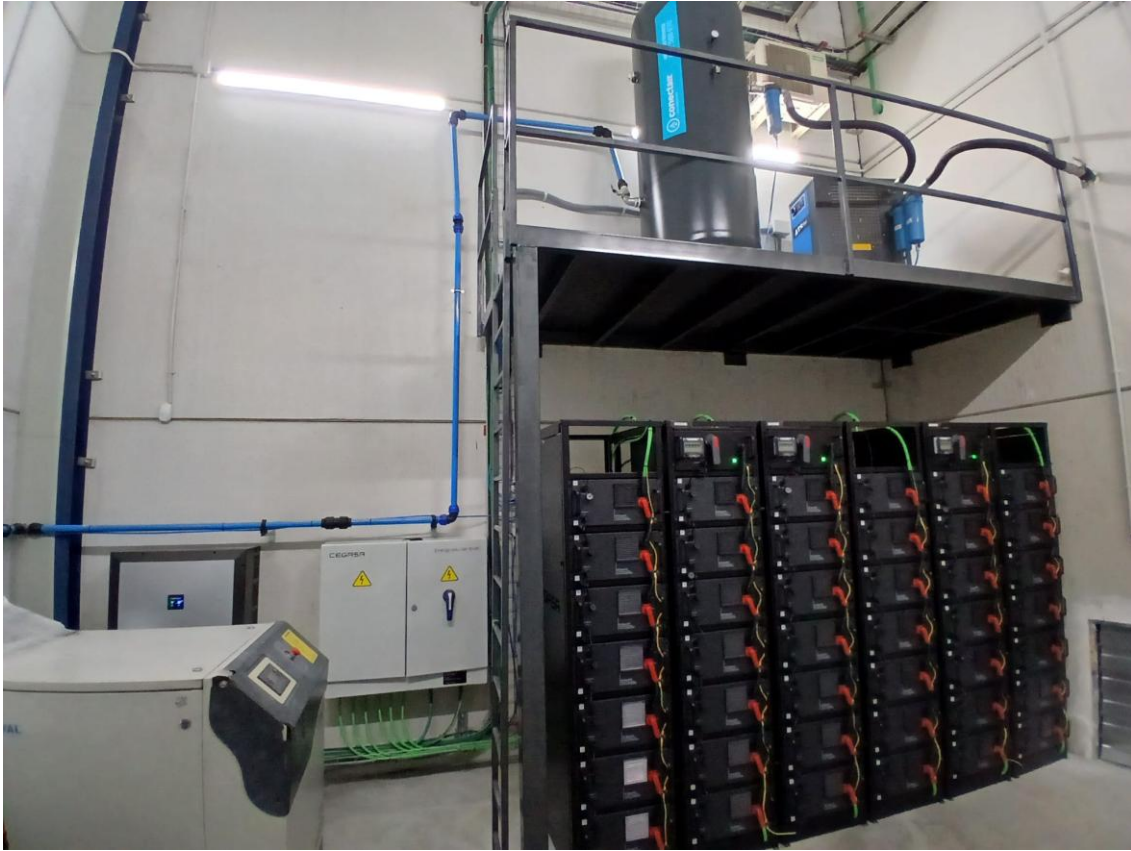
Foto: Sala de instalación del sistema BESS, con cuadro de protección en CC e inversor híbrido.
