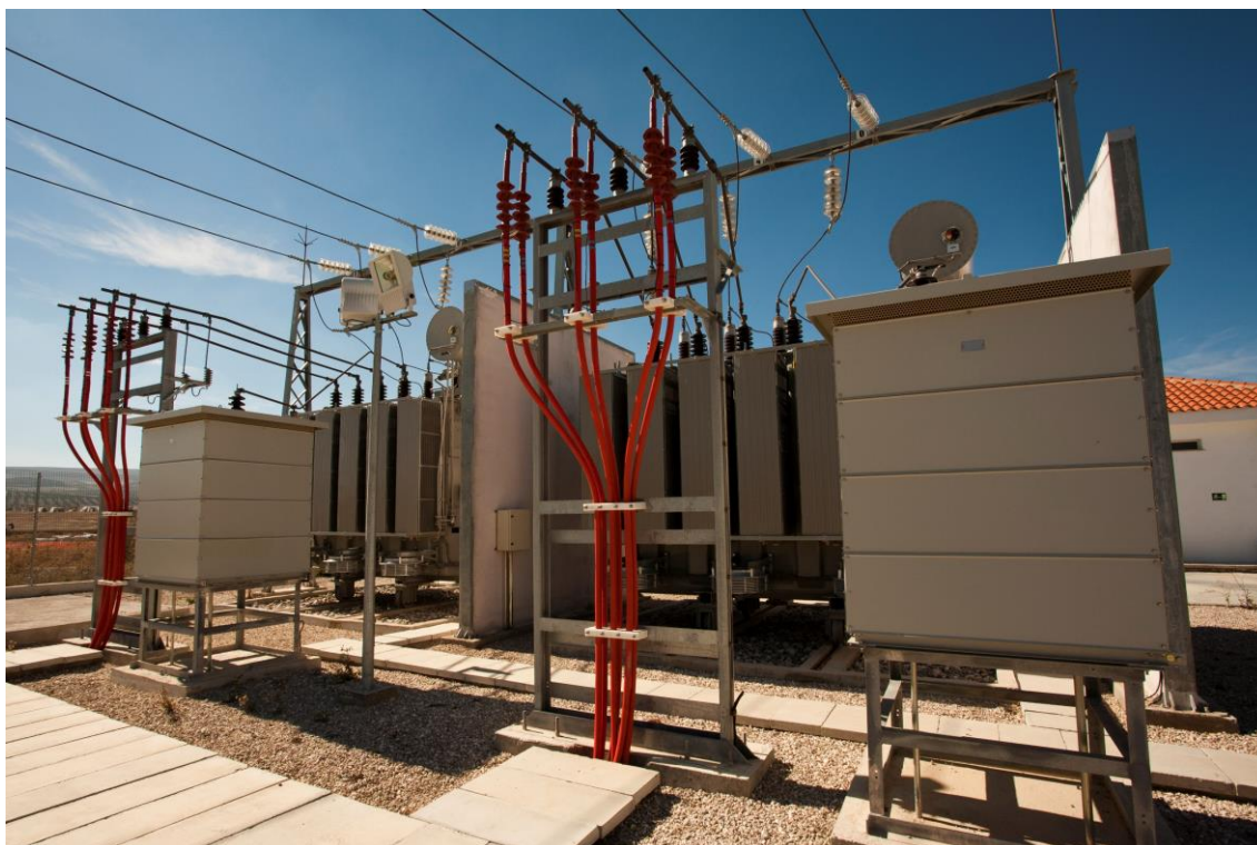
Foto Subestación de Escúzar de Cuerva
